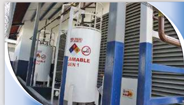
Área de almacenaje de combustible para los generadores
