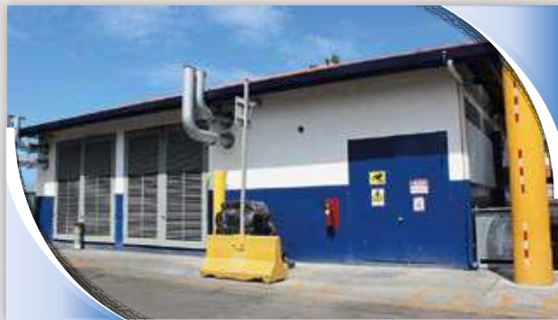
Área de Generación de respaldo de electricidad
