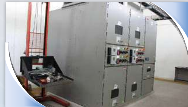
Cuarto de fuerza, monitoreo y medición
