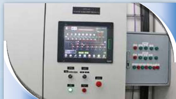
Cuarto de control
