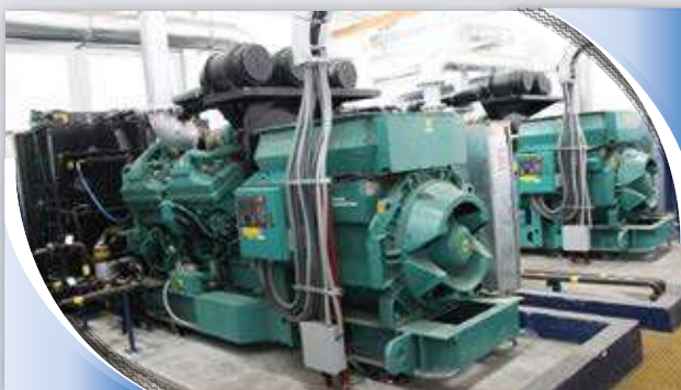
Cuarto de máquinas
